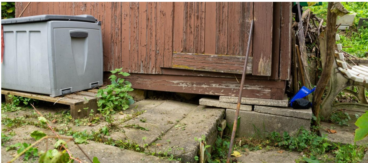
Abbildung 13: Gartenhütte am westlichen Rand des Gemeinschaftsgartens, unter der im sandig-kiesigen Untergrund T. magnum Nesteingänge angelegt hatte. (Aufnahme vom 08.10.2025)
