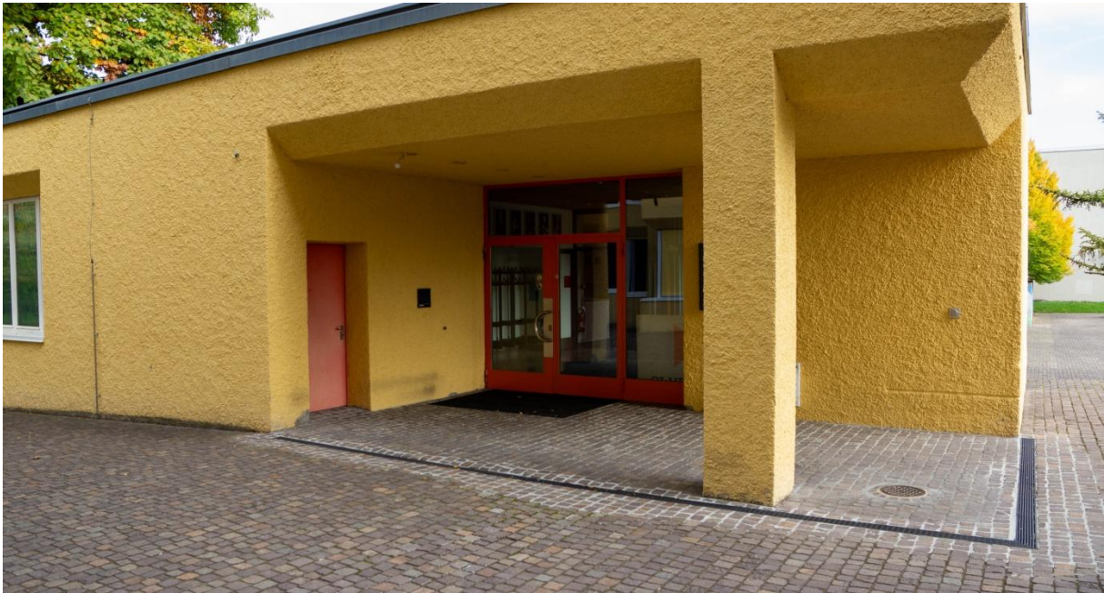
Abbildung 26: Im Sommer wurde wohl viel Aktivität von Tapinoma magnum am Haupteingang der Singhalle Allmend festgestellt, wo die Tiere in Ritzen zwischen Fassade und Pflastersteinen eindringen (Aufnahme vom 08.10.2025)
