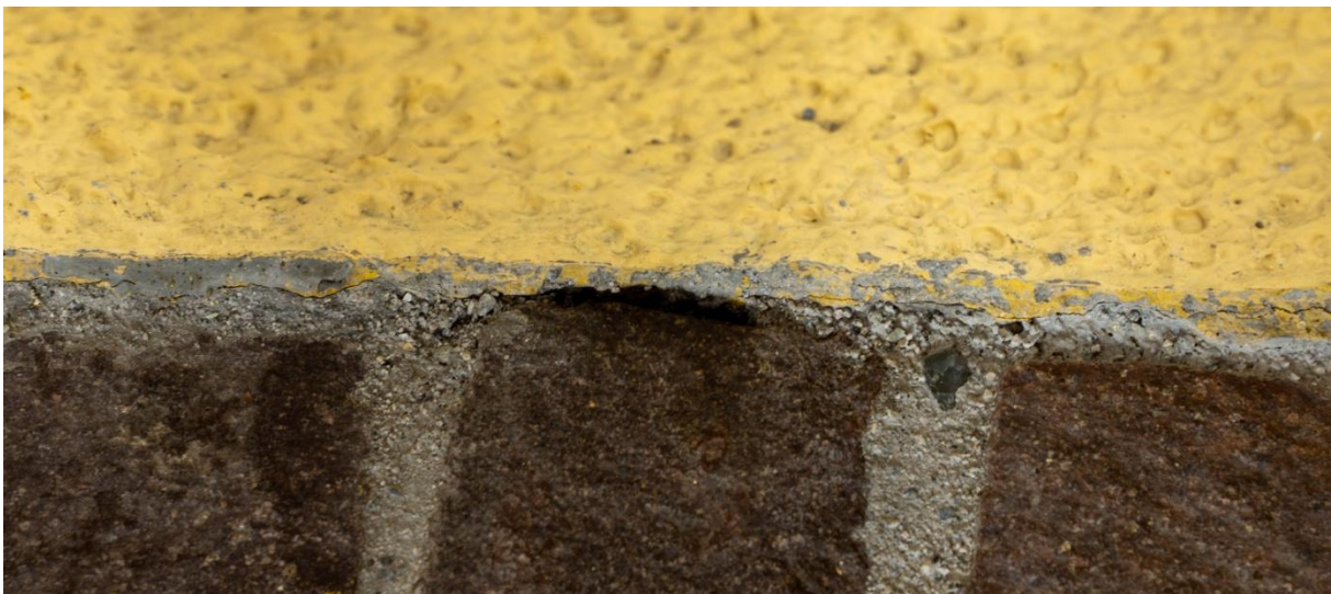
Abbildung 27: Im Sommer wurde wohl viel Aktivität von Tapinoma magnum am Haupteingang der Singhalle Allmend festgestellt, wo die Tiere in Ritzen zwischen Fassade und Pflastersteinen eindringen (Aufnahme vom 08.10.2025)
