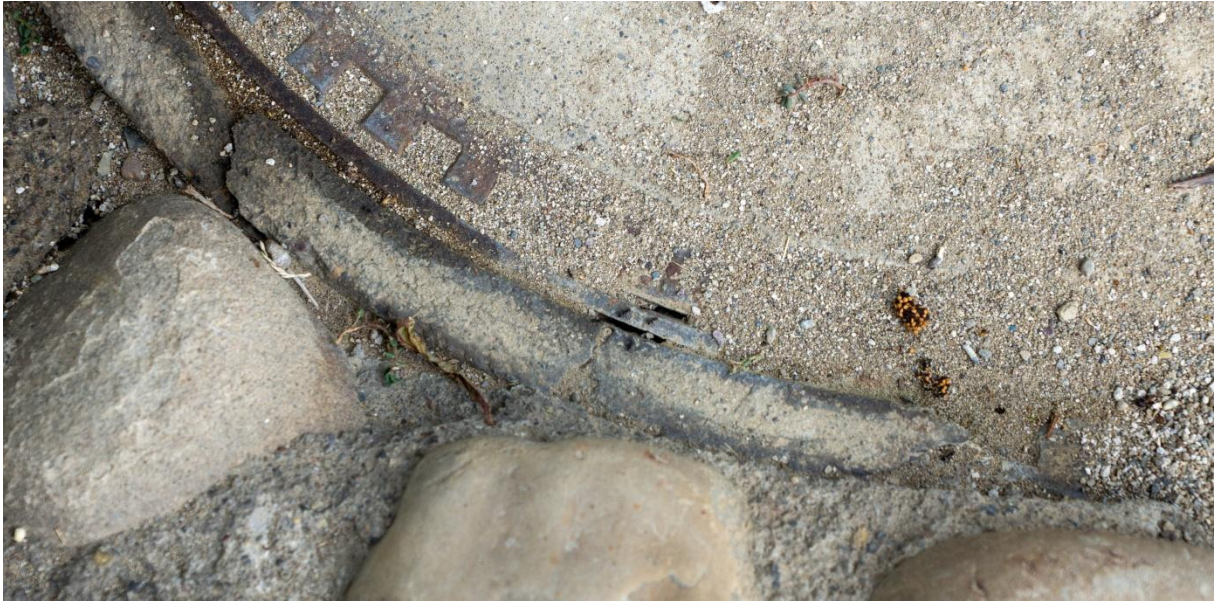
Abbildung 35: Tapinoma magnum ließ sich besonders nahe der östlichen Fassade des Werkshofgebäudes finden. Hier drangen die Tiere neben einem Schachtdeckel ein (Aufnahme vom 08.10.2025)
