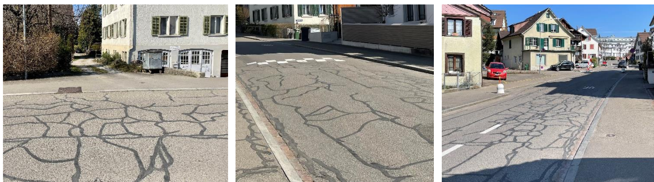
Aktueller Zustand Fahrbahn Dorfstrasse (Quelle: Landis AG, 11. März 2024)
